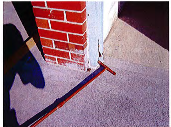
DOOR FRAME CORROSION
